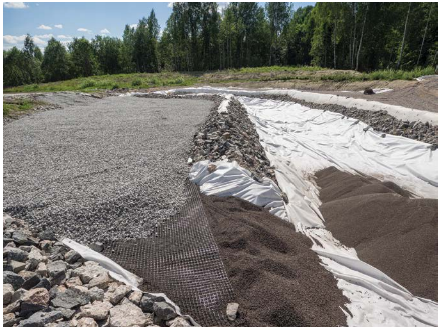
En sektion innehåller det finkorniga filtermaterialet Filtralite P som produceras vid Leca-fabriken i norska Raelingen.
