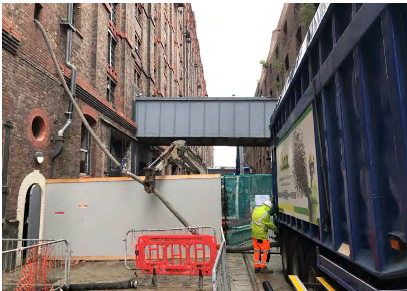
Med ett rörsystem på 50 m över en 10 m hög vägg
