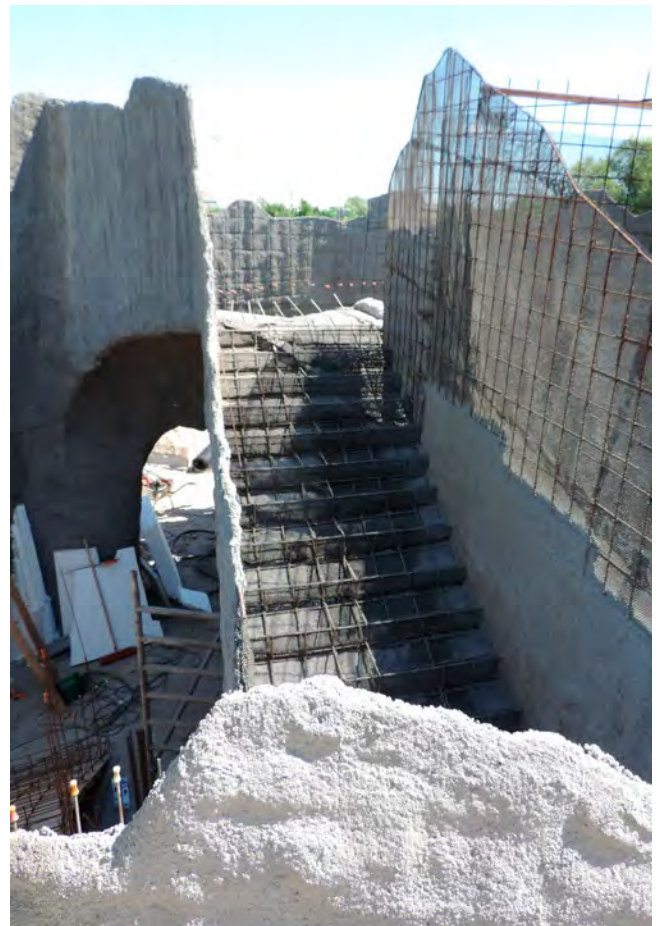
Under trappan och plattformen återfinns Leca Lättklinker.
