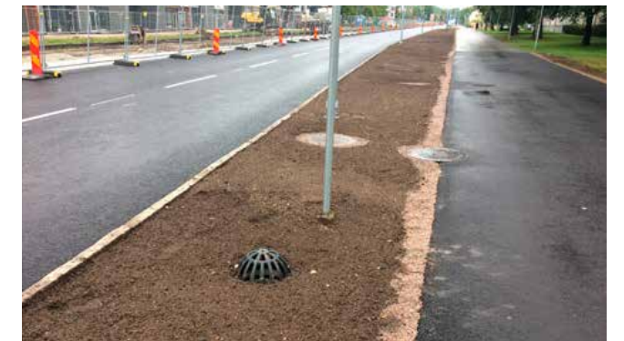
Installationen syns inte när den väl är klar. Materialbyte sker via installerade brunnslöck.
