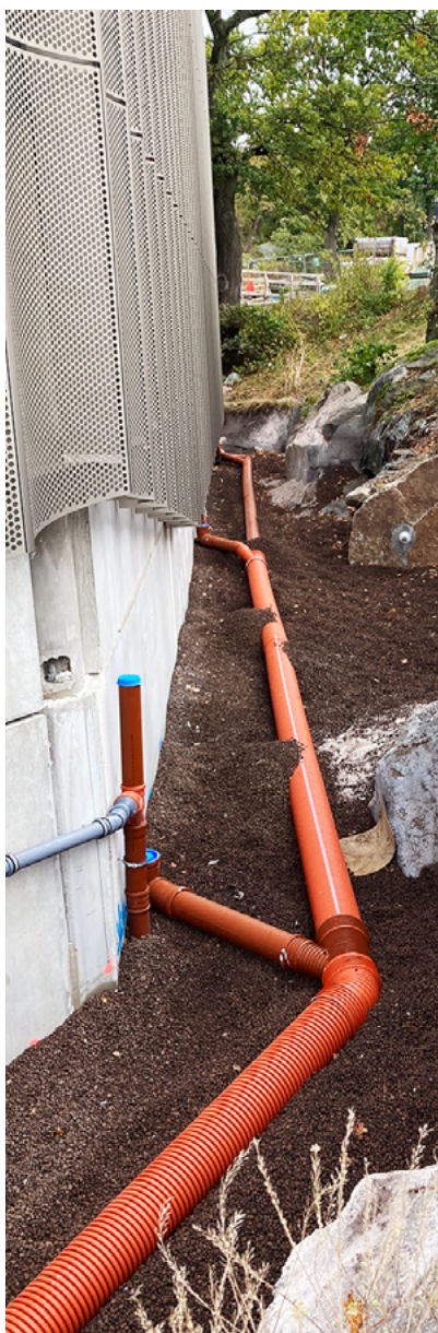
Leca lättklinker används som återfyllnad för att stabilisera den porösa berggrunden intill byggnaden.
