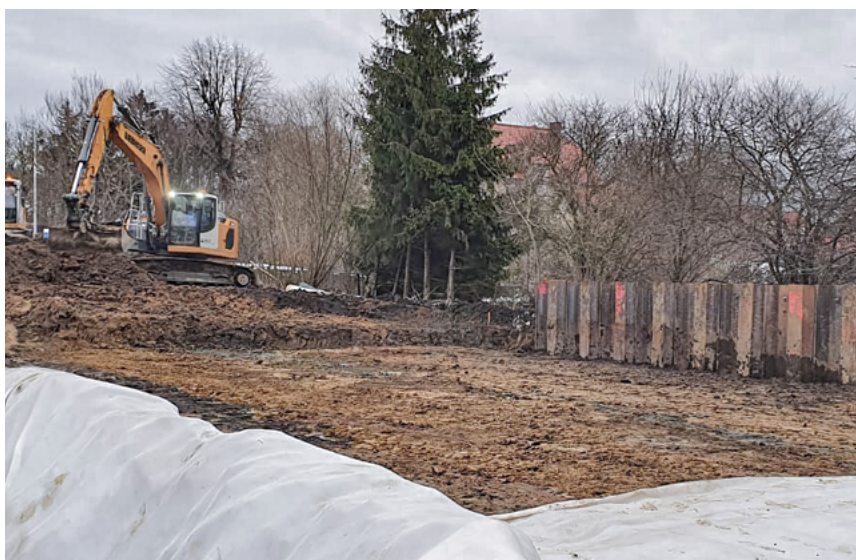
En skyddsstruktur för spårbäddens krön anlades i form av en stödstruktur bestående av en sektionvis förankrad stålspontvägg.
