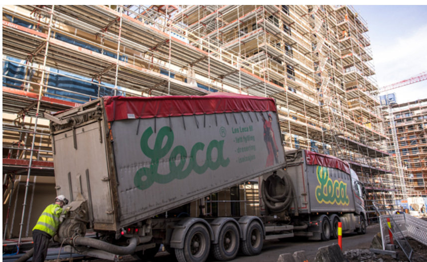
Det går snabbt och lätt att lägga ut Leca Lättklinker om man jämför med alternativ som polystyren, som kräver både byggkranar och betydligt mer arbetskraft.
