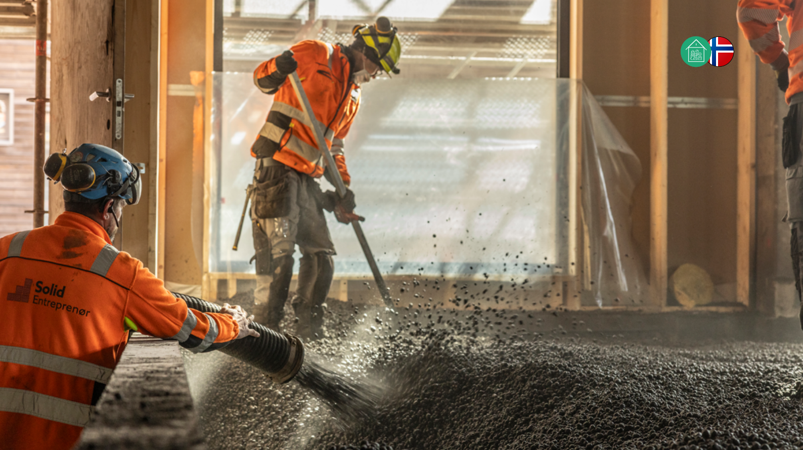
Leca Lättklinker blåslas på plats direkt från lastbilen, praktiskt för-packad utan behov av manuell lossning. Det går att gå på utan problem och dessutom levereras det utan förpackning.
