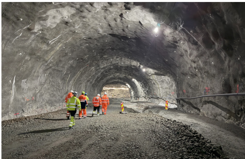
Projektteamet på plats i Brattfjelltunneln, där Leca lättklinker används för frostskydd och dränering.
