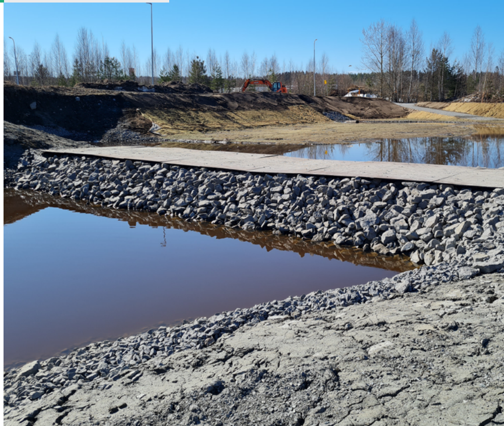
Den färdiga dammen filtrerar vatten innan det leds bort.
