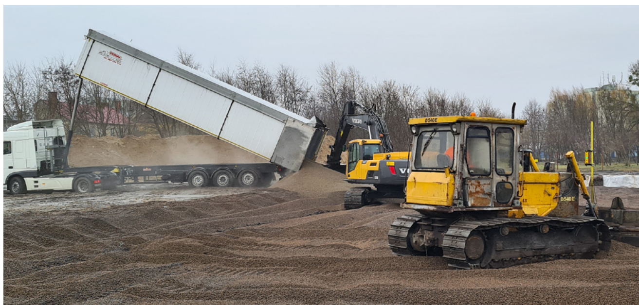
Leca lättklinker levererades genom tippning, en snabb och effektiv installation direkt på byggarbetsplatsen.
