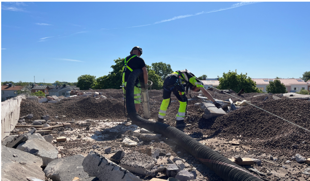
En person hanterade sugslangen och en person flyttade undan betongbitar som inte skulle sugas upp.
