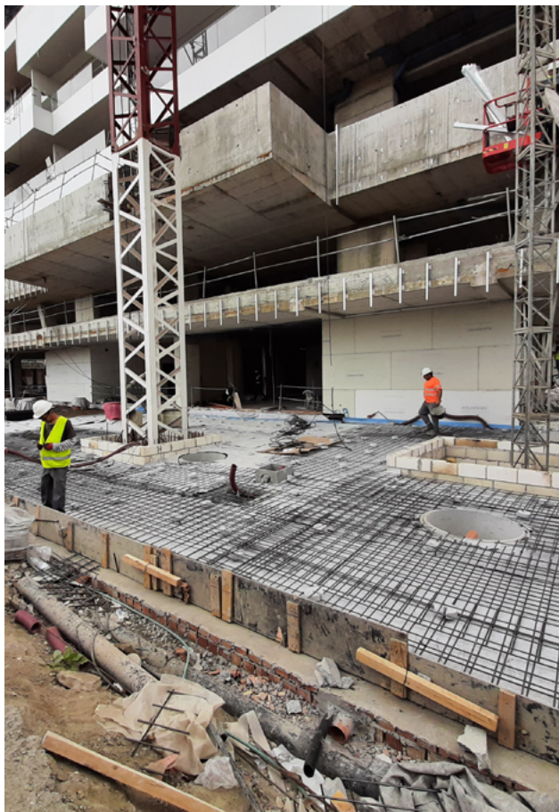
I Arlita-fyllnaden finns även dräneringsrör som förhindrar ansamling av vatten och potentiell överbelastning.
