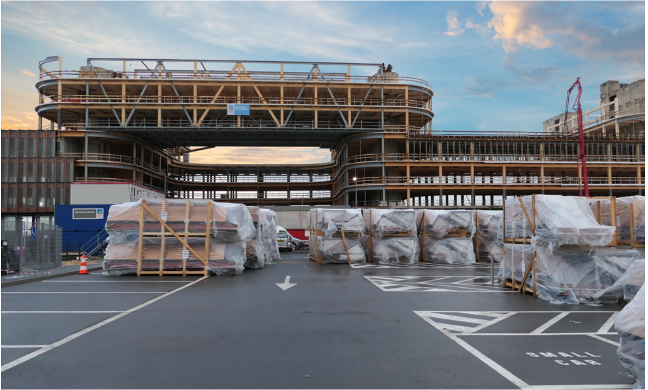
Skypark Business Centre vid Luxemburgs flygplats är den hittills största träkonstruktionen i Europa.
